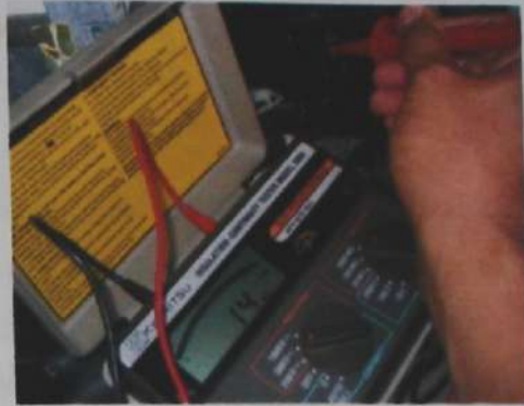
Rajah 3.14 : Ujian Penebatan ( Insulation Test ) Pada Motor Pemampat Sedang Dijalankan
